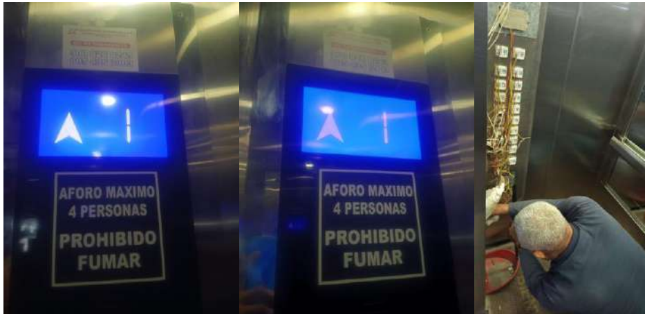
Cambio de Display ascensores 1 y 2
